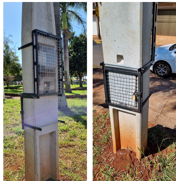
GRADIL PARA PROTEÇÃO DA ENTRADA DE ENERGIA E DO PAINEL ELÉTRICO
