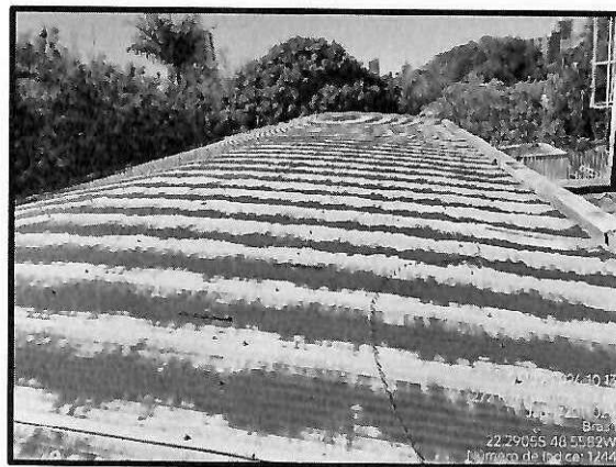
Figura 2 – Cobertura em arco com telhas onduladas em estado de corrosão
